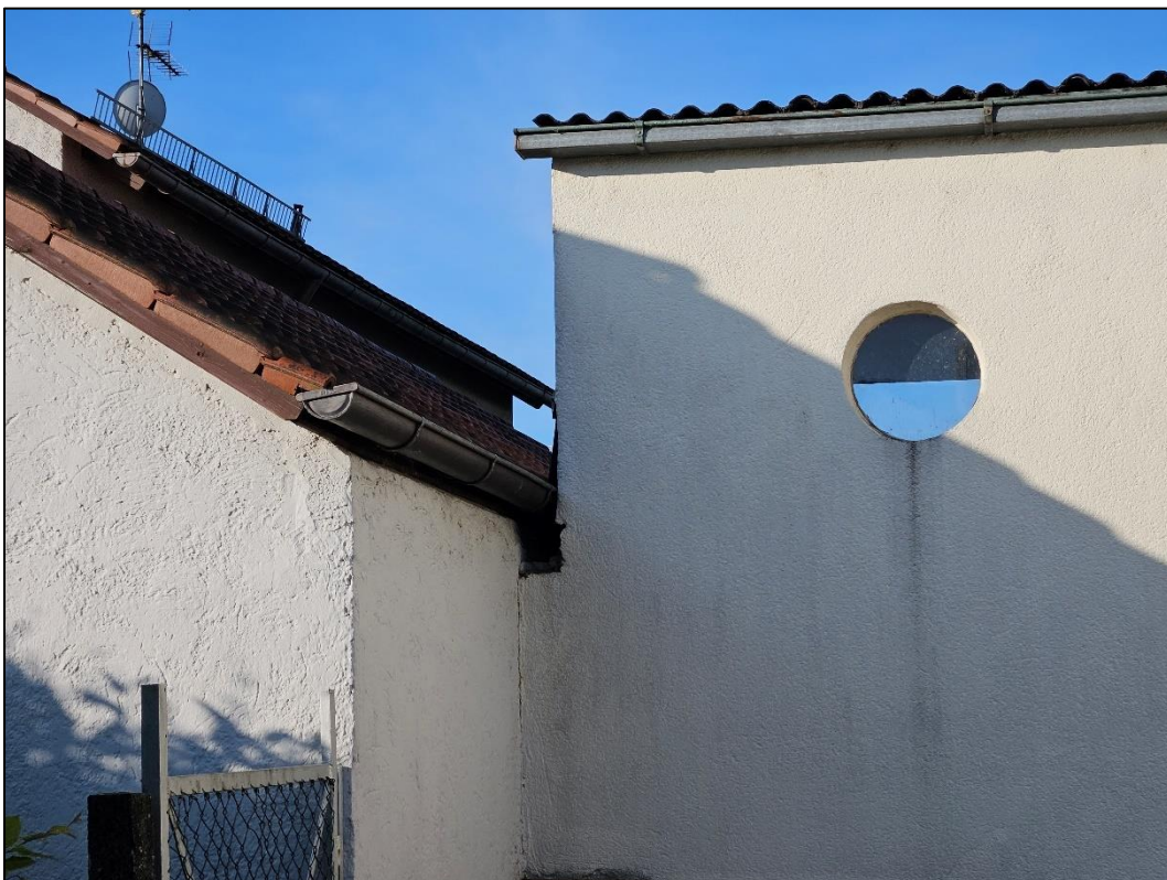
Abbildung 14: Nische unter Dachrinne am Übergang der Garage zum Nachbarhaus.
