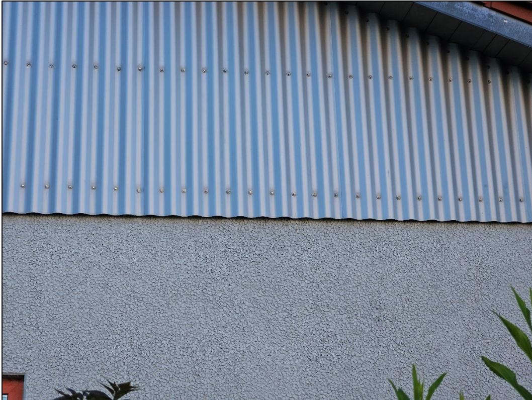
Abbildung 23: Fassade der Westseite des Penny-Markts mit Haussperling-Brutplatz hinter Wellblech.
