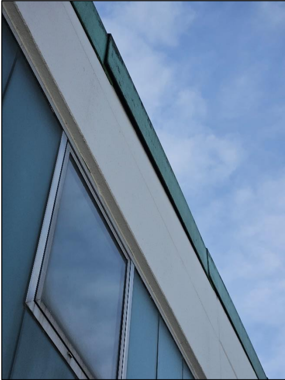
Abbildung 29: Spalte mit Fledermauspotenzial an Dachkante der Nordseite des Baumarkts.
